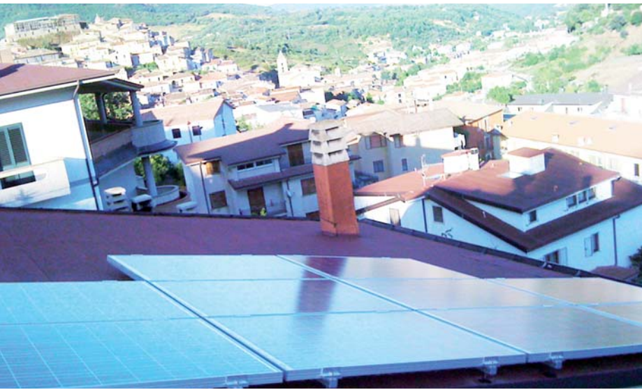
Uno degli impianti fotovoltaici installati dalla Girasole
